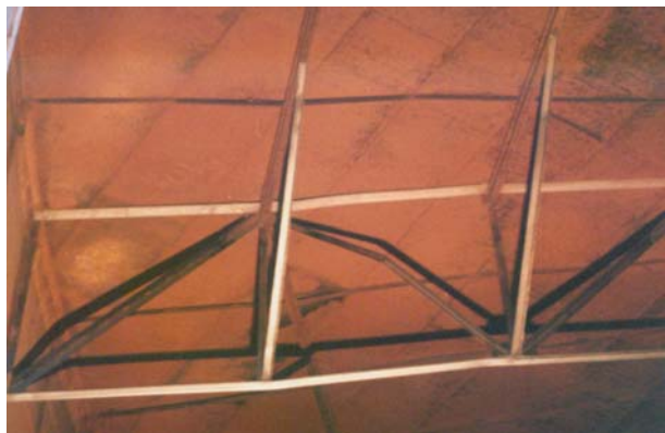
Slika 9. Oštećeni štapovi krovnog nosača
