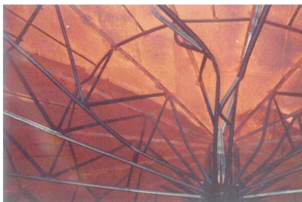
Slika 8. Izgled deformiranih krovnih nosača uz središnji stup
