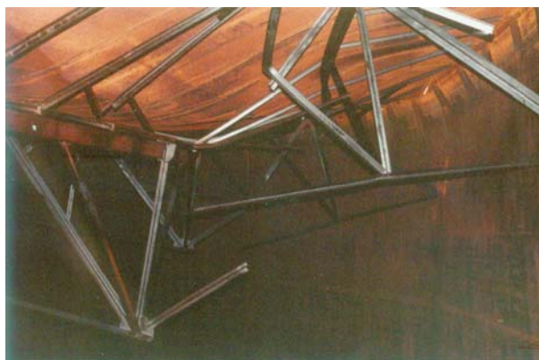
Slika 7. Urušeni krovni nosači
